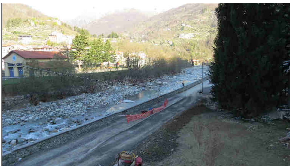
Foto n° 4: Ripresa fotografica da monte della viabile posta in sommità al muro, con scavernamento sviluppato a seguito delle piogge del Marzo 2017
