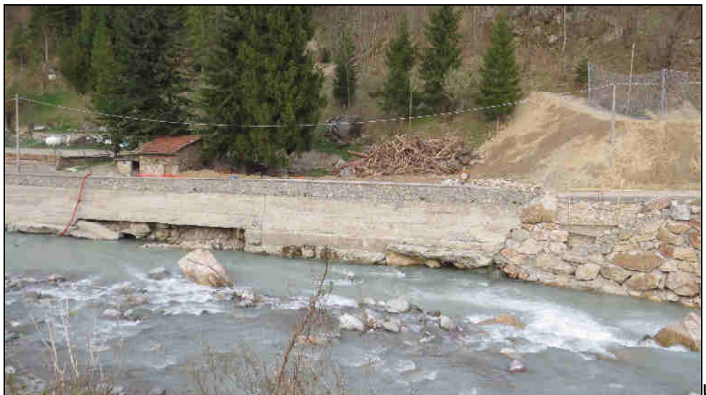
Foto n° 3: Ripresa fotografica del tratto di muro scalzato alla base in corrispondenza di loc. Ceresè
